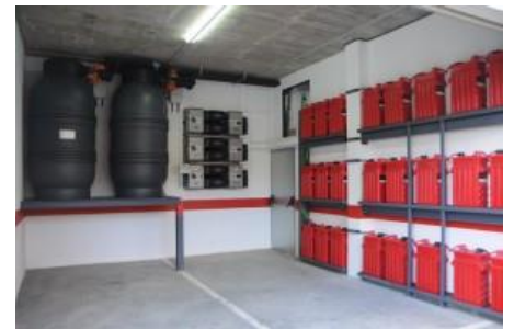
Sala on hi ha les bateries solars
