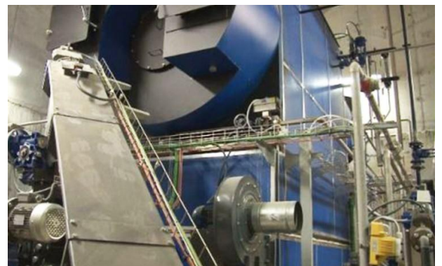
Caldera de biomassa
