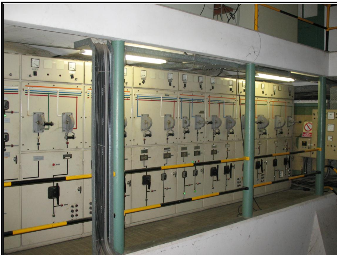
Imatge corresponent a uns panells de control de la central. Aquests permeten una gran quantitat d'opcions de funcionament. Està situat al costat de la turbina 2 (Francis)
