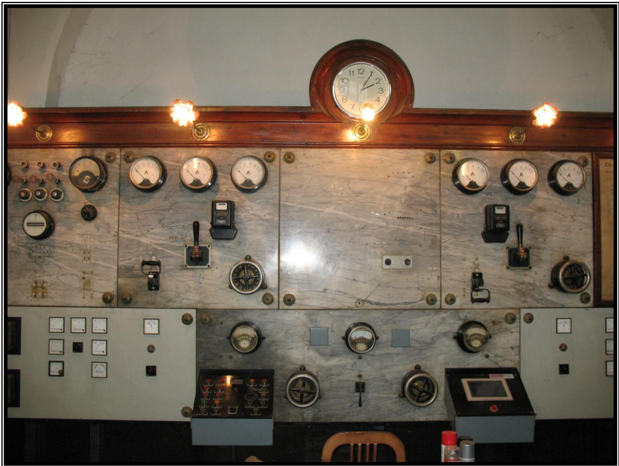
Antic panell de control de la central de Vilanna. Actualment està completament en desús (la central està totalment automatitzada). Si pot observar un rellotge que tampoc funciona, uns panell de posta en marxa i aturada de la central, i dos panells idèntics per controlar i recollir les dades de les dues turbines. (Font: Elaboració pròpia)
