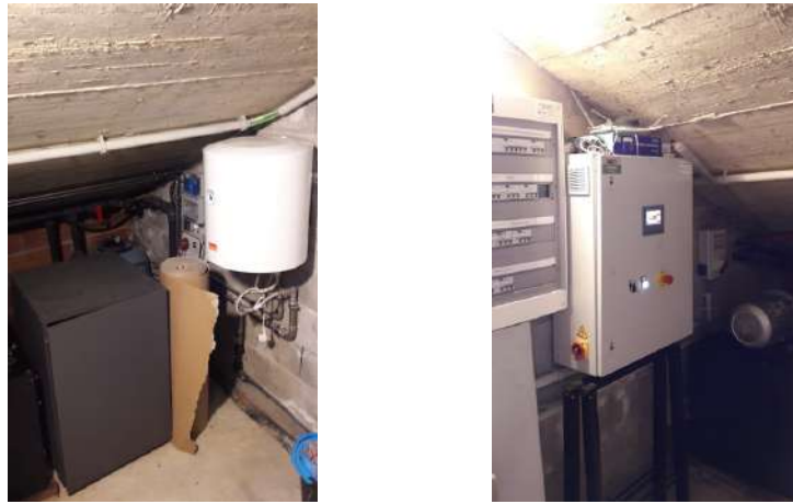
Figura 51. Imatges del motor del mòdul mòbil i de la caldera i quadre elèctric de l'edifici
