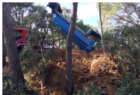
44. Abocaments a la muntanya de Sant Sebastià, inclosa a la moratòria.
